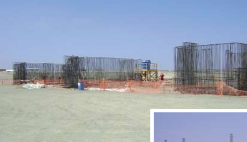
Izquierda: Fundaciones de los vaporizadores, estructuras de hormigón que elevan la temperatura del gas para transformarlo de estado líquido a gaseoso. Abajo: Vista del futuro edificio de bodega de 8 m de alto. Los edificios están fundados sobre mejoramiento de hasta 2 m de material seleccionado.
