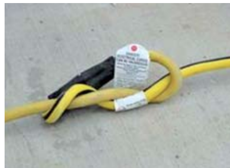
Falta de cuidado en la manipulación de extensiones portátiles.
