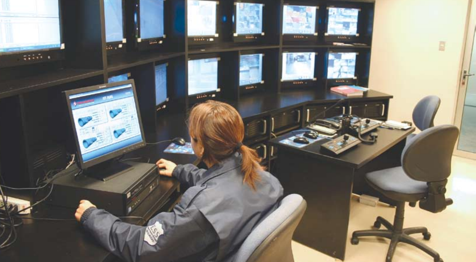
La iluminación y ventilación del recinto son controladas en todo momento.
