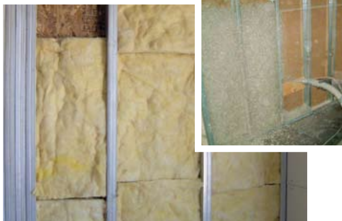
Material aislante térmico y absorbente acústico al interior de un tabique.
