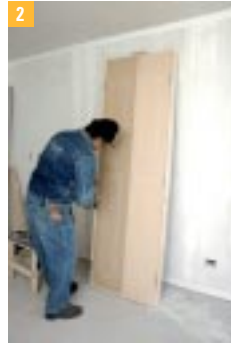
2 Separación o descuelgue de los marcos de las puertas
