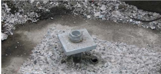
Micropilote instalado con su espacio anular inyectado con adhesivo epóxico (Pilotes Terratest).
