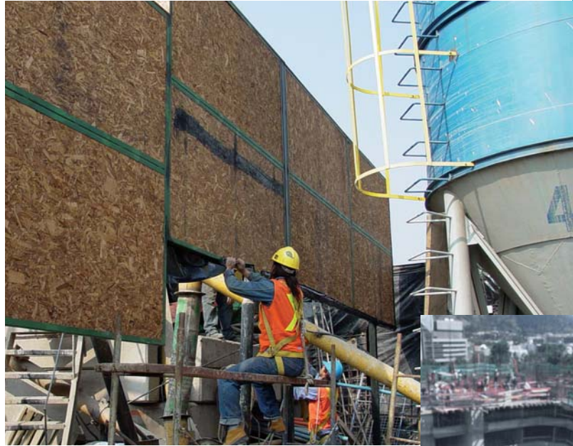
Planchas de OSB aíslan equipos ruidosos.
