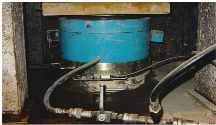
Gata Hidráulica en el Interior de la Pila
