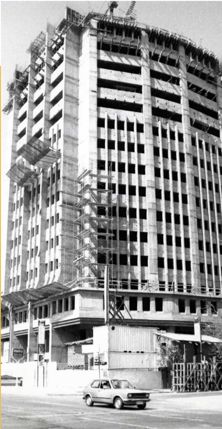
Vista del edificio de la CChC en calle Marchant Pereira, durante su construcción. 1987
