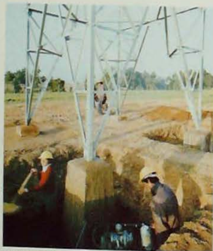
TORRE ALTA TENSION, LINEA LA SERENA-VALLENAR
