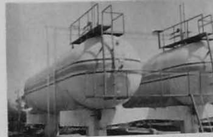
Estanques de 50 000 Kg. para almacenamiento de gas
