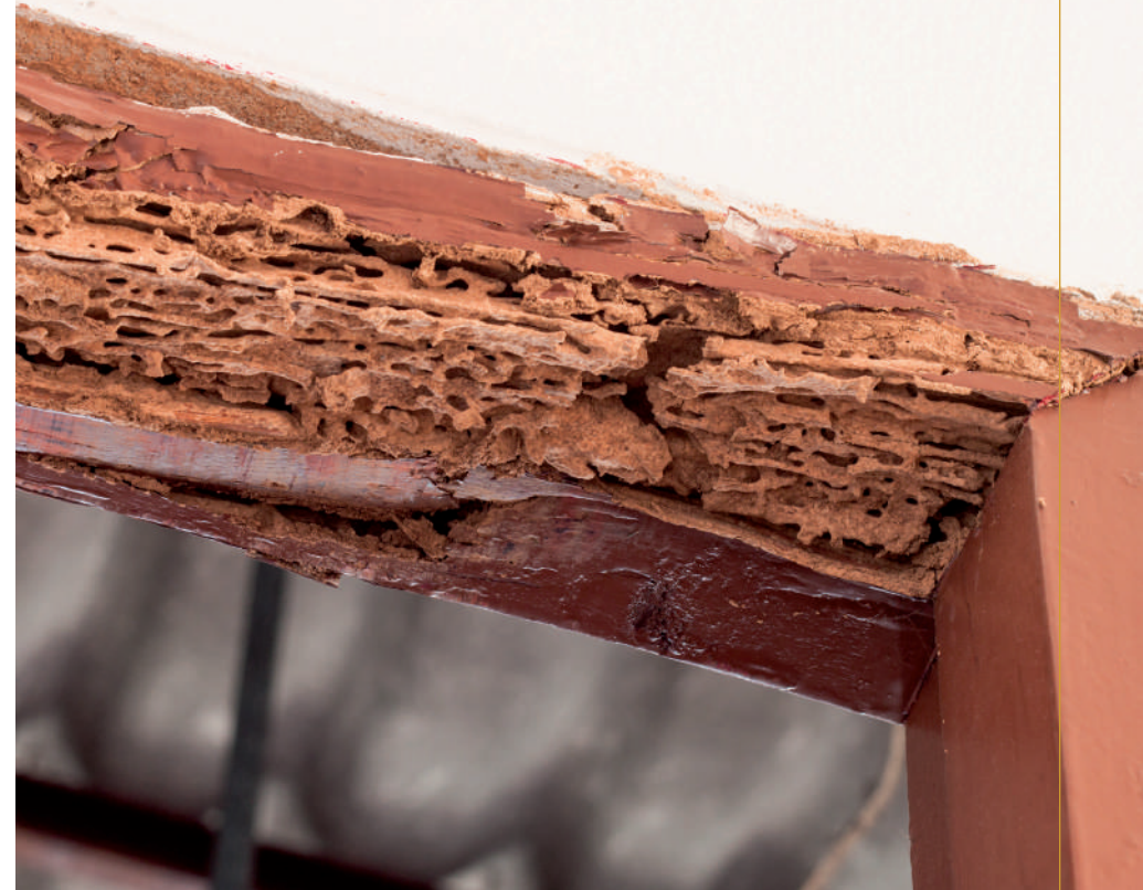
↑ Efectos del ataque de termitas en las viviendas.
