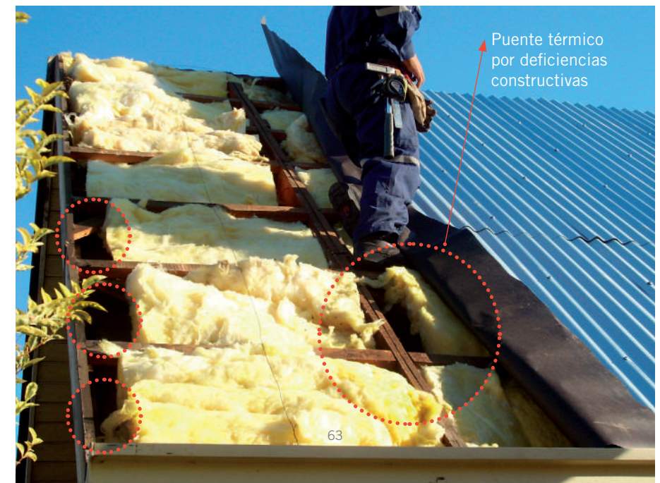
↓ Techumbre con puente térmico por mala instalación.
