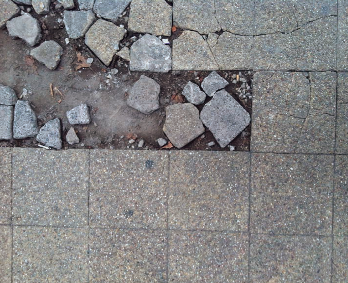
EJEMPLO DE PAVIMENTO QUE REQUIERE REPOSICIÓN DE PIEZAS
