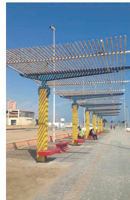
SOMBREADOR EN MAL ESTADO DEBIDO A LA CORROSIÓN, ANTOFAGASTA
