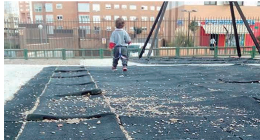
EJEMPLO DE PAVIMENTO AFECTADO POR EL CLIMA Y LA FALTA DE CONSERVACIÓN. PARQUE DEL UNIVERSO, PARLA, ESPAÑA
