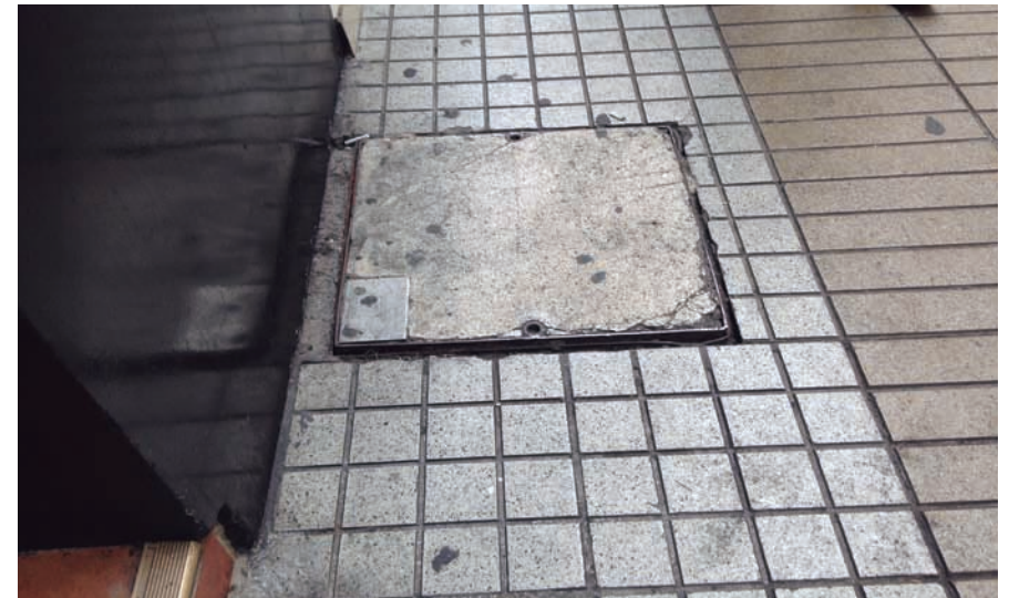
REGISTROS DETERIORADOS Y MAL NIVELADOS, SANTIAGO
