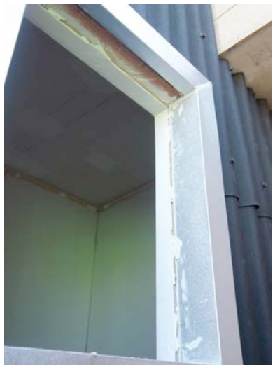
Figura 10.14: Sellos de poliuretano inyectado en marcos de ventanas
