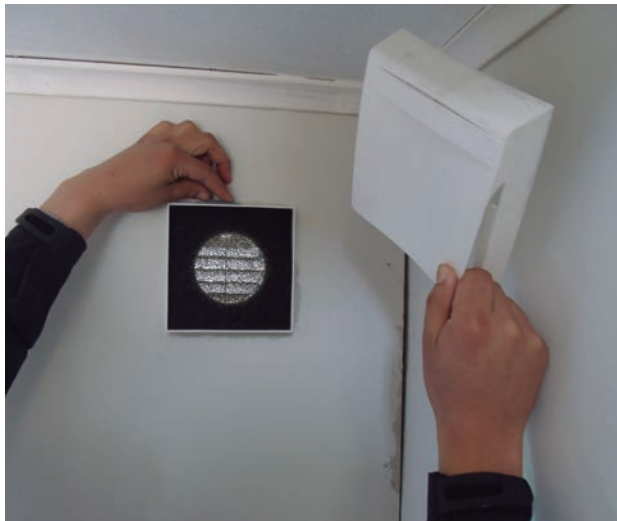
Figura 10.17: Aireadores operables en muros envolventes
