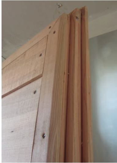
Figura 10.37: Puerta de acceso de madera con doble contacto
