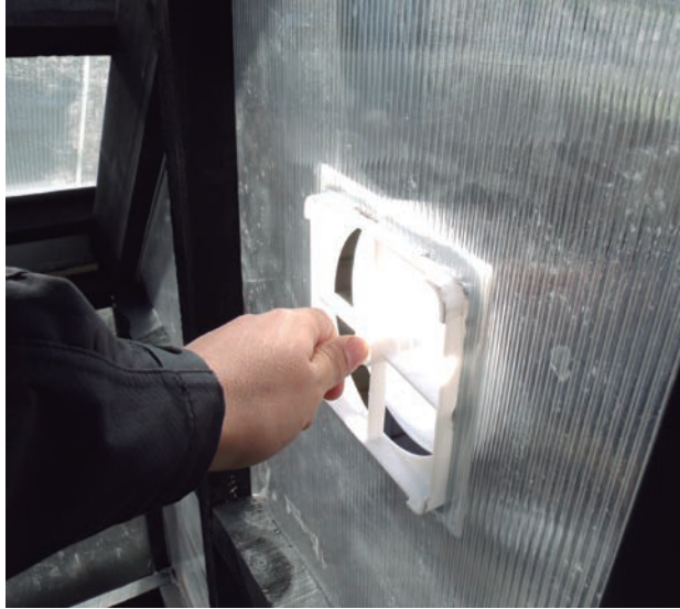
Figura 10.16: Aireadores operables en espacio solar
