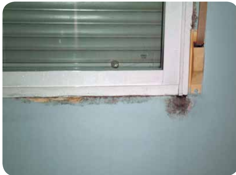
Figura 5.42: Patologías generadas por humedades indeseadas en un mal sellado
