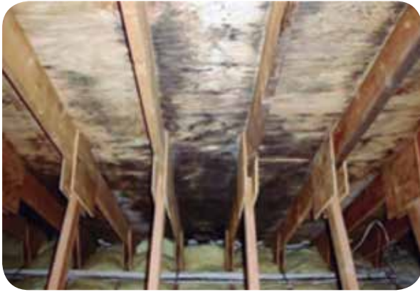
Figura 2.17: Condensación en techumbre
