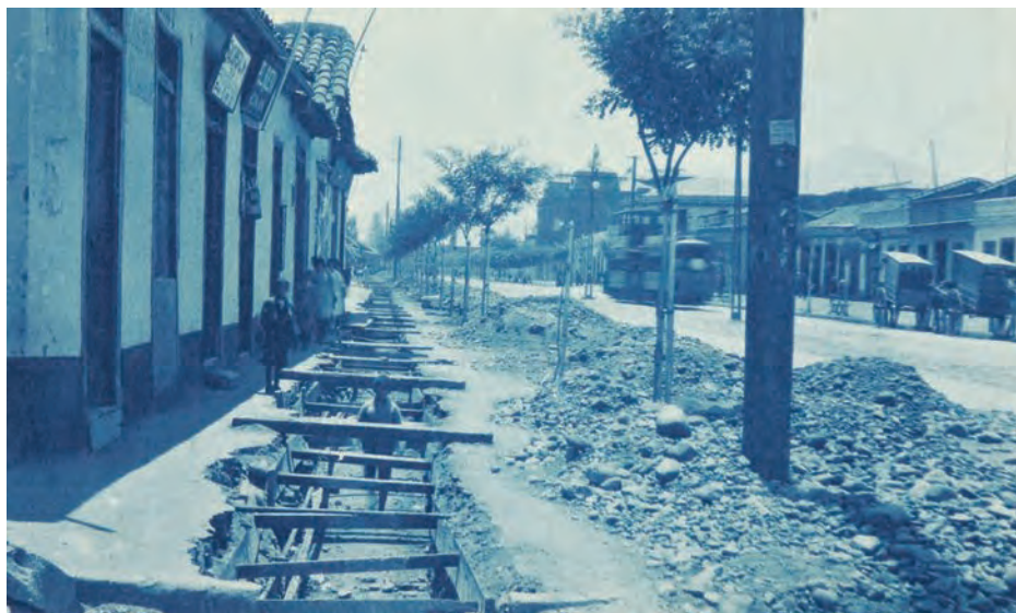
Trabajos de alcantarillado en calle Independencia, de Colón al norte. Colección Museo Histórico De Chile
