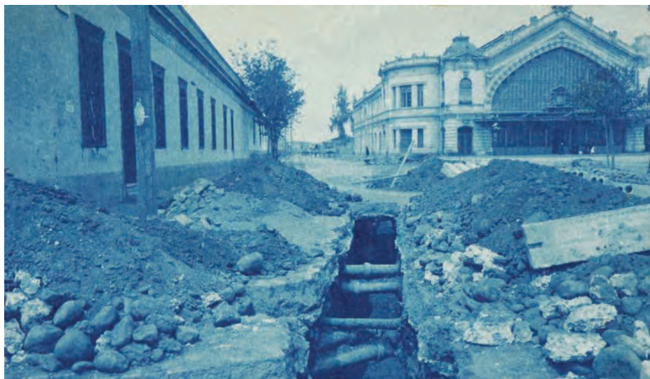
Calle General Bustamante. Trabajos de alcantarillado a un costado de la estación Pirque en Providencia 1921. Colección Museo Histórico De Chile
